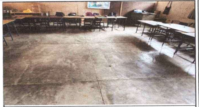
Foto 2: Cambio de piso de torta a piso ceramico del aula de segundo ya que se encuentra en mal estado ya que tiene 40 años de elaboración
