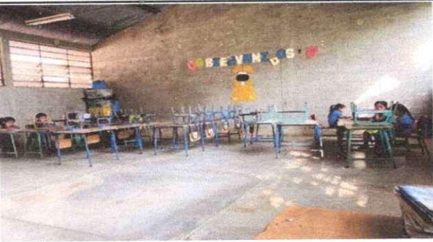
Foto 3: Cambio de piso del aula de preprimaria por piso ceramico ya que sen encuentra en malas condiciones
