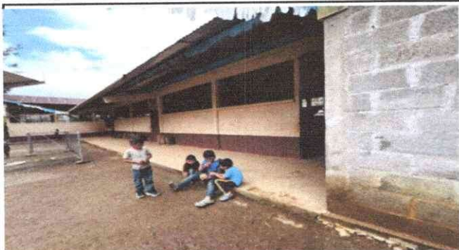
Foto 1: Cambio de pintura del establecimiento ya que se encuentra en mal estado.
