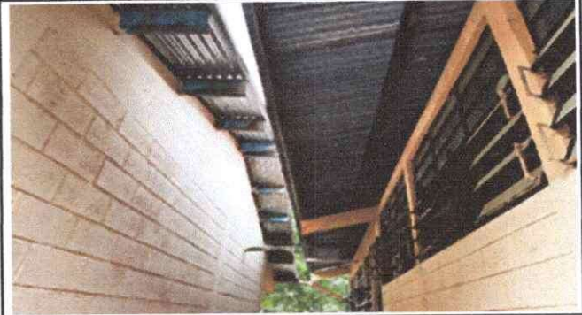
Foto 2: cambio de pintura del establecimiento se encuentra en malas condiciones.
